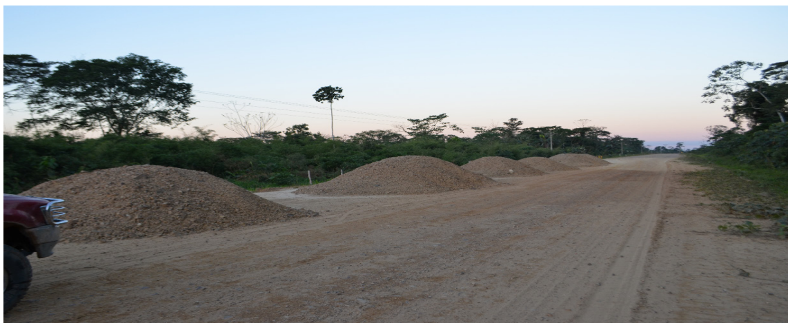
图2：玻利维亚San Buenaventura – Ixiamas高速公路未完成的建设工作
